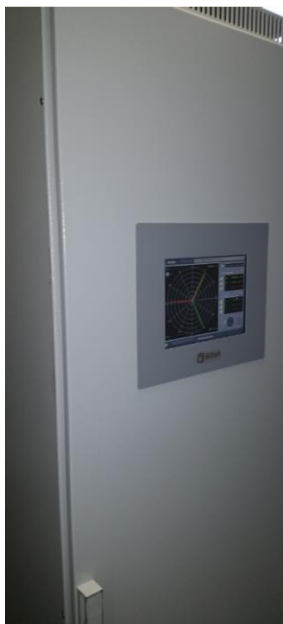
Рисунок 7. Внешний вид шкафа с панельным компьютером подсистемы диагностики
